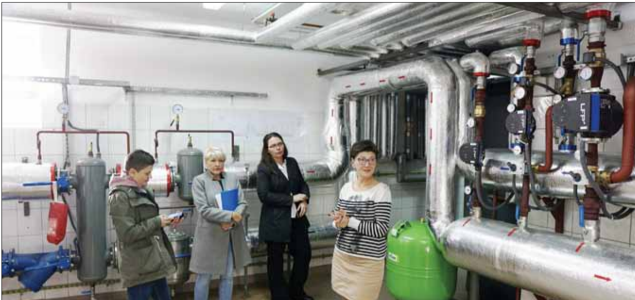
Dzięki nowej kotłowni ogrzewanie szkoły będzie skuteczniejsze i tańsze
