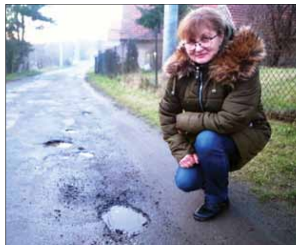
Sołtys Żeleznika Bożena Matwijiszyn wielokrotnie wnioskowała o remont fatalnego odcinka drogi powiatowej przebiegającej przez wieś
